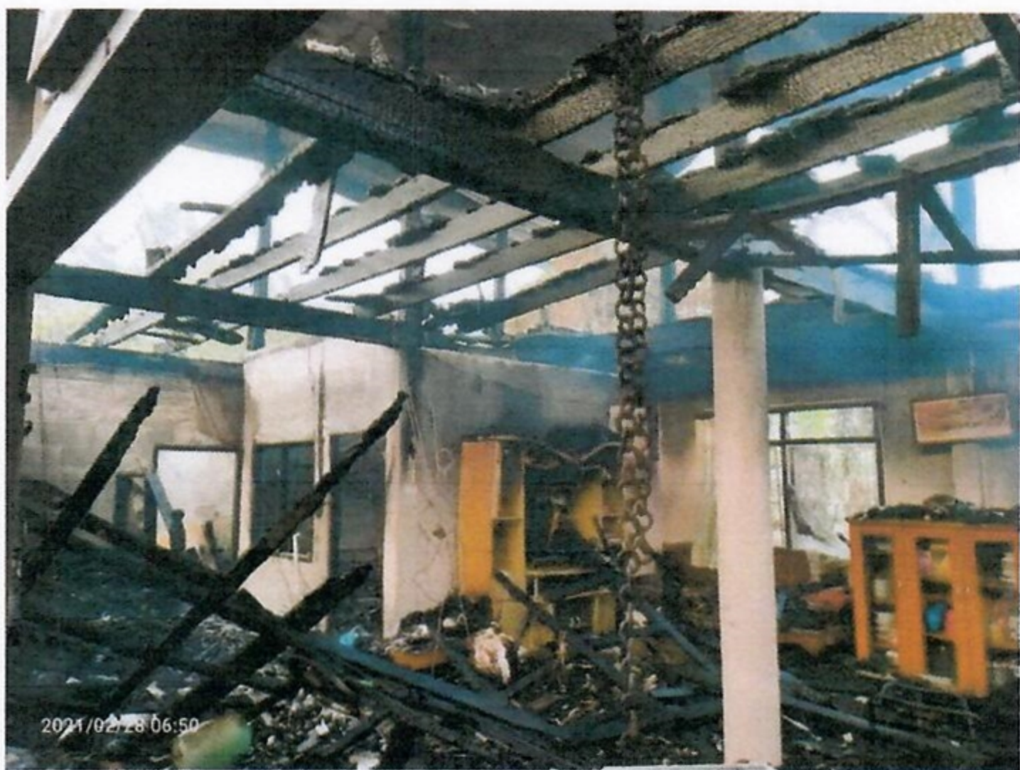
สภาพบ้านที่เกิดเพลิงไหม้เมื่อวันอาทิตย์ที่ ๒๘ กุมภาพันธ์ ๒๕๖๔ เวลา ๐๓.๐๐ น. บ้านเลขที่ ๓๕ หมู่ ๑๔ ต.เสือเปลอ อ.กุ่มกวาปี จ.อุดรธานี เป็นบ้านของนายคมกริช คำลาภ พนักงานจ้างทั่วไปปฏิบัติหน้าที่ ณ สนามกีฬาเทศบาลนครอุดรธานี
